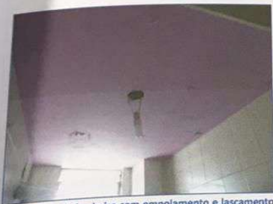
Foto 9 - Teto do banheiro com empolamento e lascamento do revestimento do apartamento avaliado
